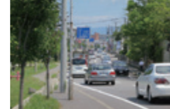
洞爺湖温泉西部の変動帯 (1977年噴火の火山性活断層により、一車線分ずれた道路)
